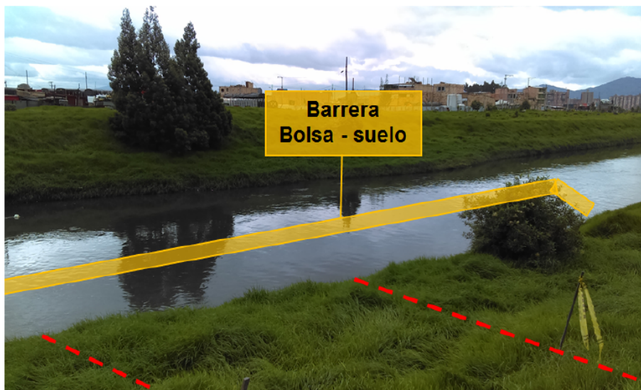
Fotografía No. 4. Sector de intervención sobre el cauce del río Fucha. En Amarillo se señala la ubicación aproximada de la ataguía o barrera en bolsa-suelo. En líneas rojas se señala la ubicación de la estructura de descarga hacia el cauce.
